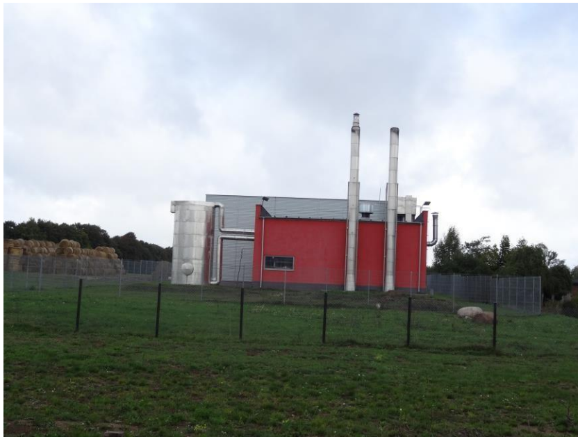
Fot. 5 Kotłownia na biomasę w Daszynie.
